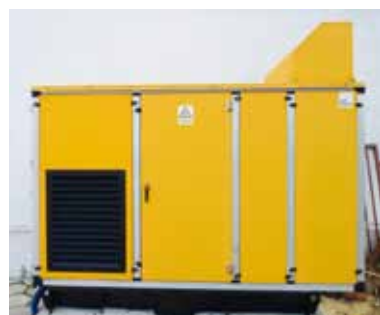
Stacjonarny agregat dużej mocy – alternatywny system zasilania urządzeń technicznych
