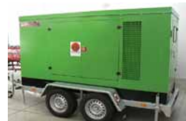
Mobilny agregat prądowórczy wysokiej mocy
